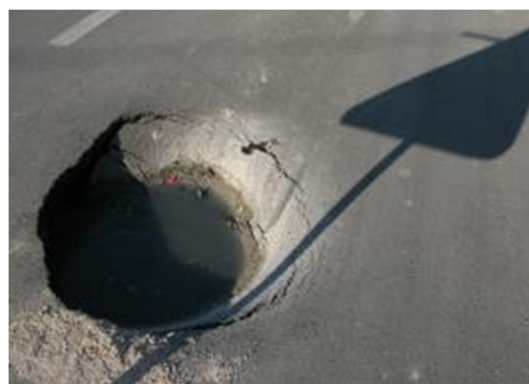
شکل ۲: نشست زمین پس از اجرا (روش حفر مقنی)
