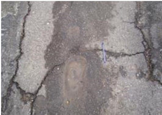
شکل ۱: نشست سطح زمین و خرابی آسفالت پس از پر کردن ترانشه و روکش کردن
