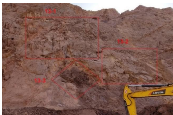
شکل ۷: زون ۱۳ جهت بررسی سطح خطر سقوط بلوک‌های مشخص‌شده.
