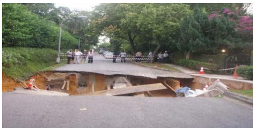
حالت حدی نهایی: ریزش زمین به داخل تونل و ایجاد یک حفره بسیار بزرگ
