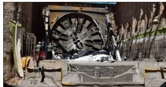
شکل ۷: کاترهد دستگاه TBM استفاده شده در حفاری تونل خط دو مترو تبریز (تهیه شده در زمان ورود دستگاه TBM به ایستگاه)
